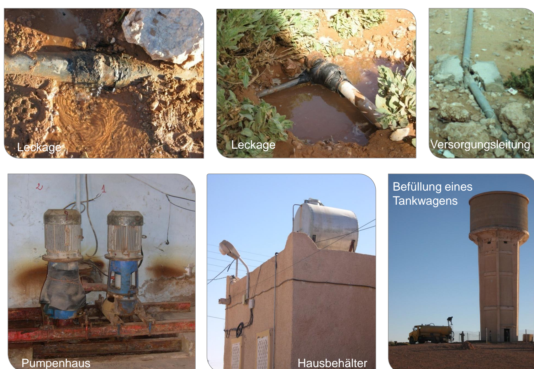
Aufnahmen zur aktuellen Situation der Wasserversorgung in Béni Abbès
